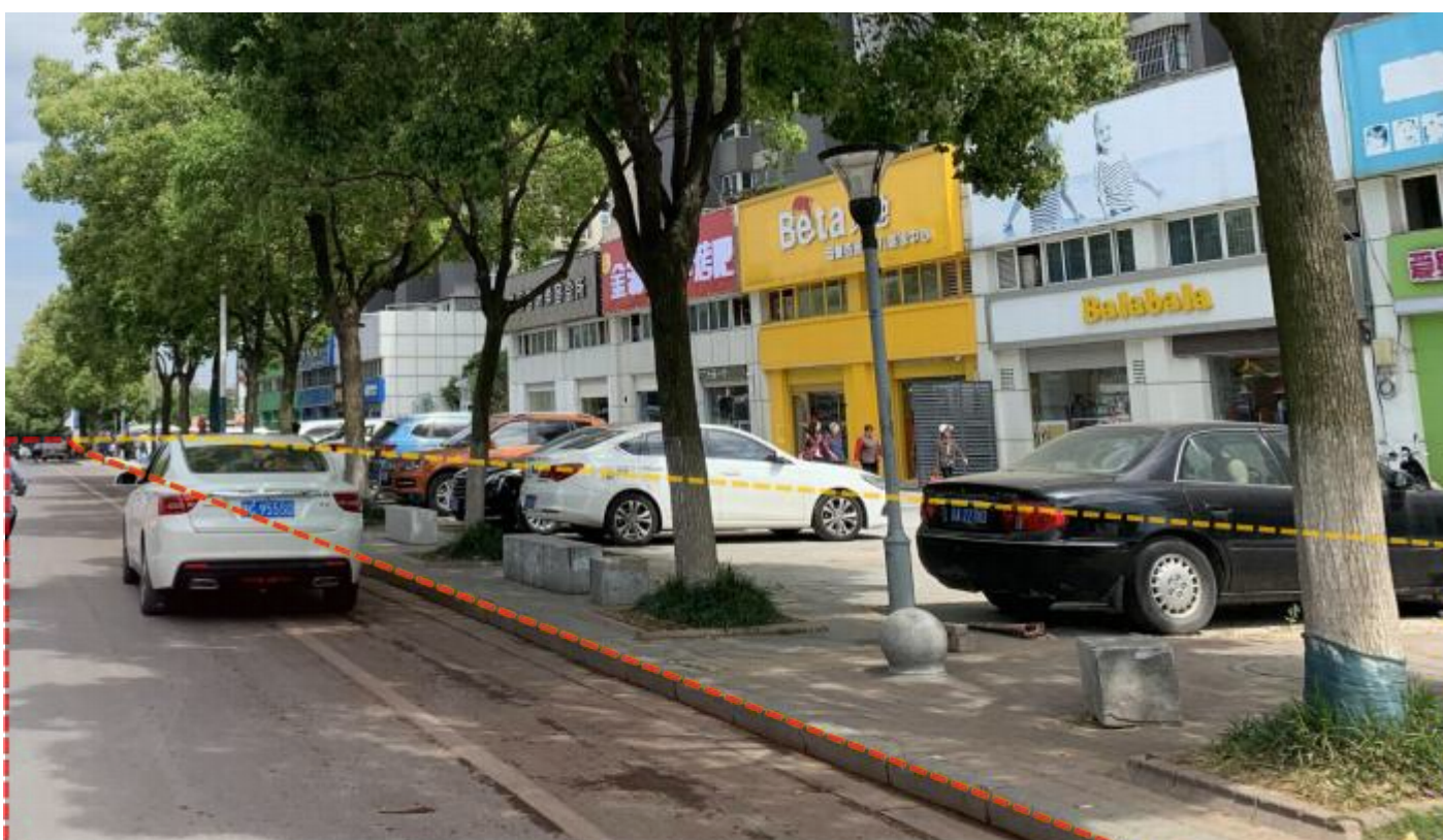
春江路：路面多为补丁，人行道铺装老旧
