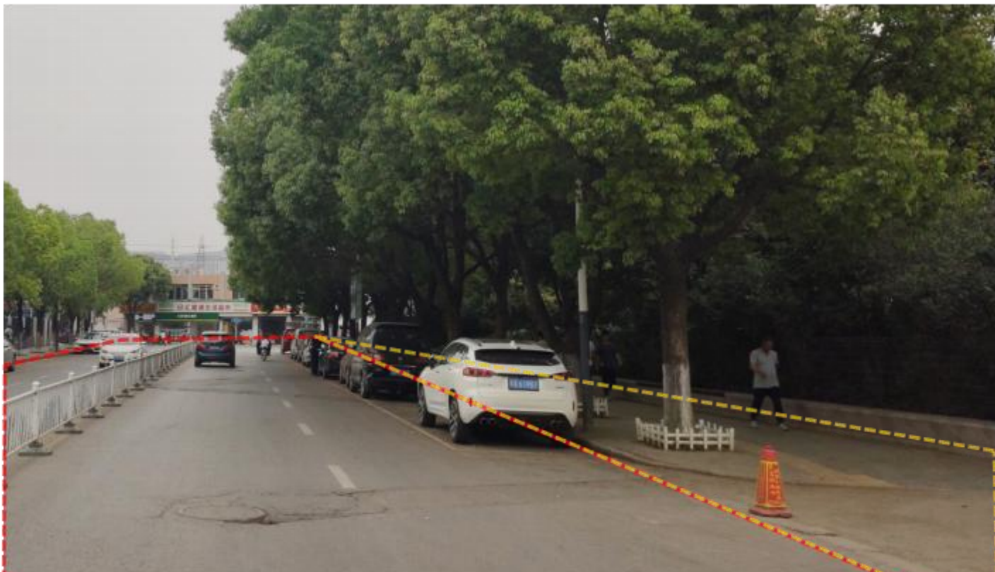
江淮路：井盖下沉，路面破损厉害
